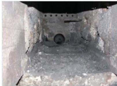
Combustore di biomasse erbacee
